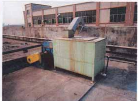
项目水喷淋烟尘吸收水池
