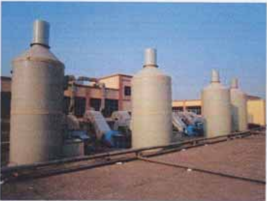
项目水喷淋粉尘吸收塔
